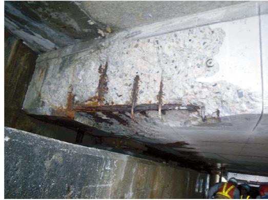
塩害により劣化した床版
